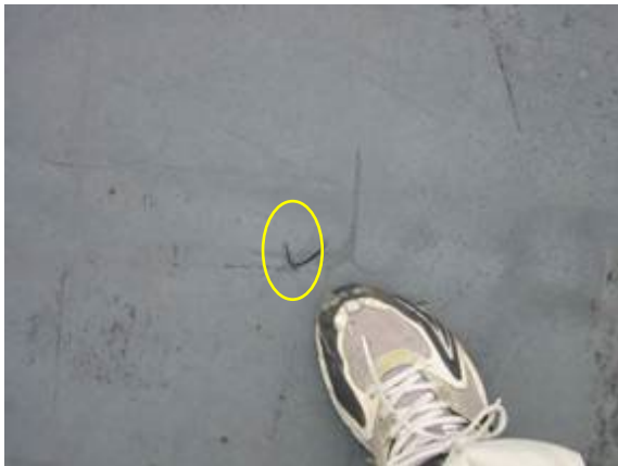
劣化度Ⅲ 損傷有り
