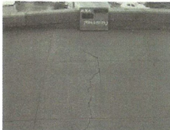
劣化度Ⅱ ひび割れ1～3mm
