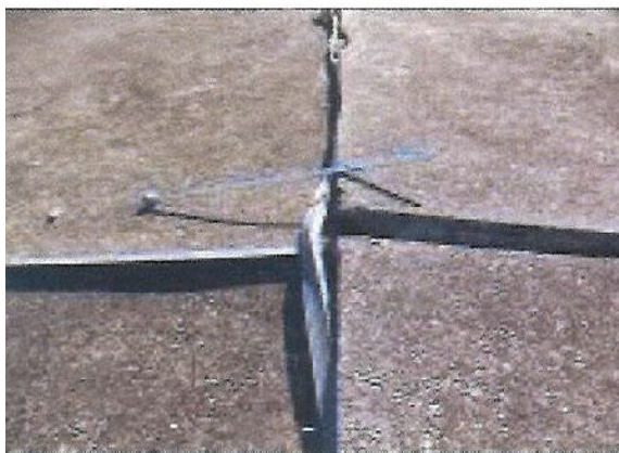
劣化度Ⅲ ひび割れ3mm以上 せり上がり
