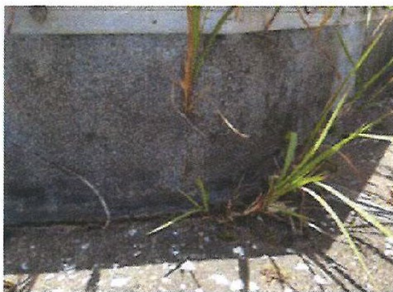
劣化度Ⅲ 防水層に貫入している
