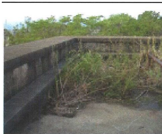
劣化度Ⅱ 防水層表面の繁殖
