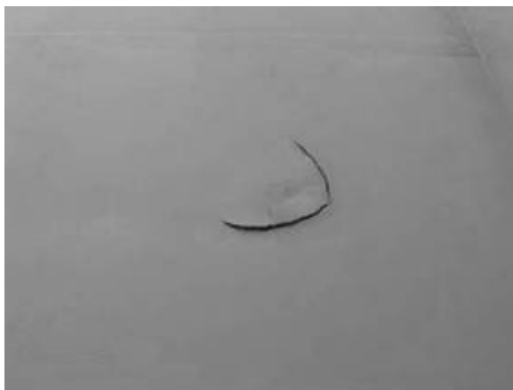
劣化度Ⅲ 損傷有り
