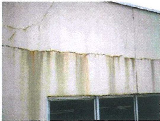
劣化度Ⅲ 押し出しあり
