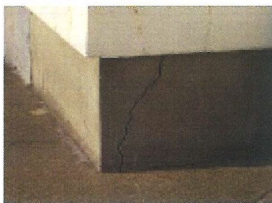
劣化度Ⅱ ひび割れ1～3mm
