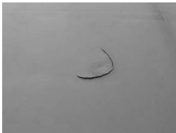
劣化度Ⅲ 損傷有り
