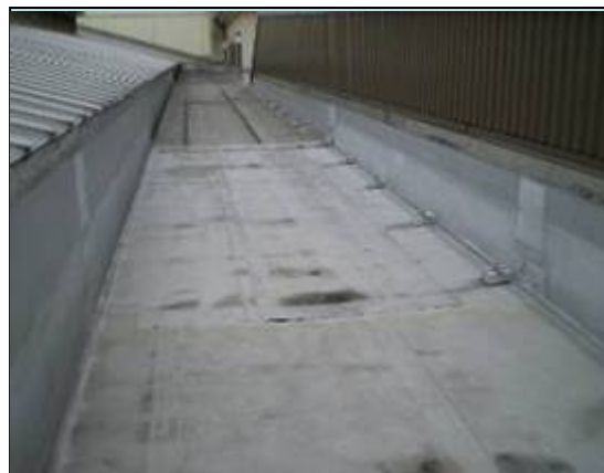
劣化度Ⅱ 接合幅の50未満～20%以上
