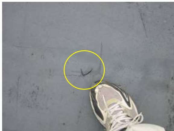
劣化度Ⅲ 損傷有り
