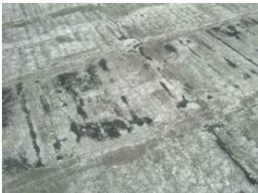
劣化度Ⅲ 保護仕上げ層の消失
