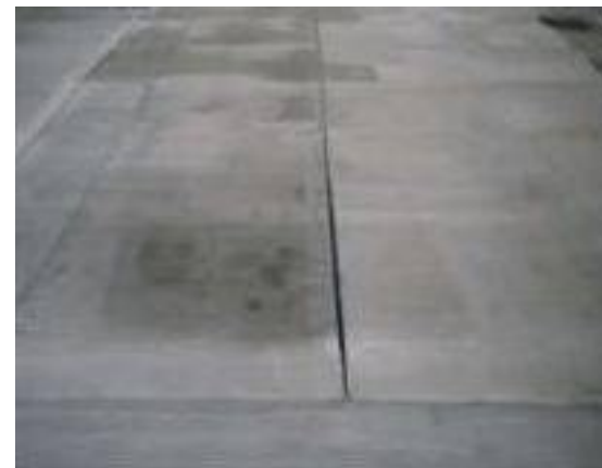
劣化度Ⅰ 接合幅の20%未満
