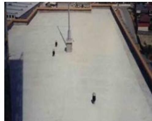
劣化度Ⅰ 保護仕上げ層の変退色
