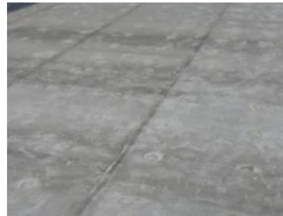
劣化度Ⅰ 問題なし
