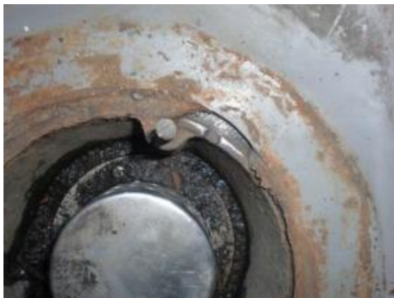
劣化度Ⅲ 剥離有り
