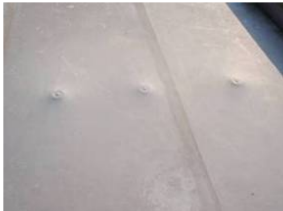
劣化度Ⅲ 固定金具浮き
