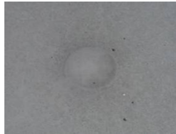
劣化度Ⅰ 問題なし
