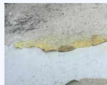
写真-3. 水溜まり付近
