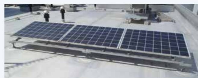
写真-5 太陽光発電設備の専用基礎による設置例
