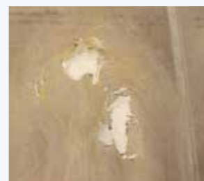
写真-2. 水溜まり付近
